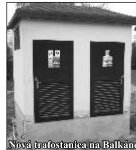
Nová trafostanica na Balkáne
