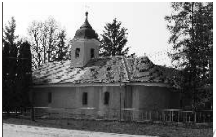
Strecha nášho kostola pred rekonštrukciou
